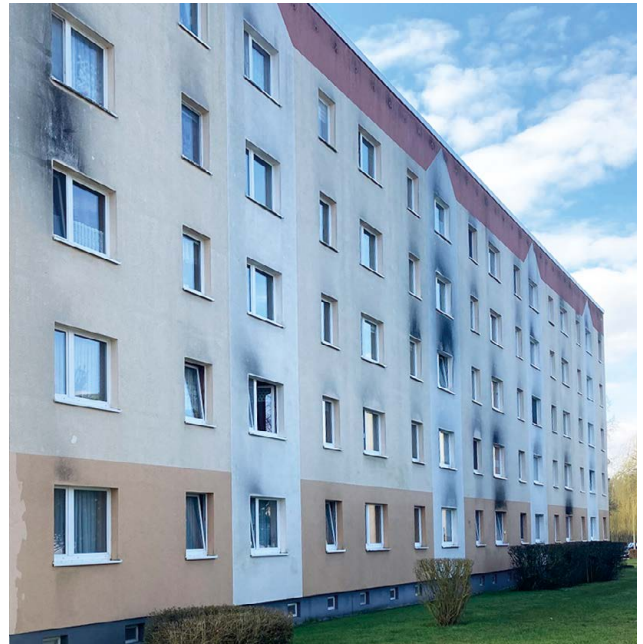
Algenbildung an Fassade – Blankenhainer Straße
